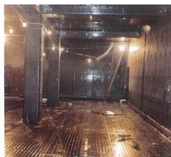
污水處理池 Sewage treatment pond
