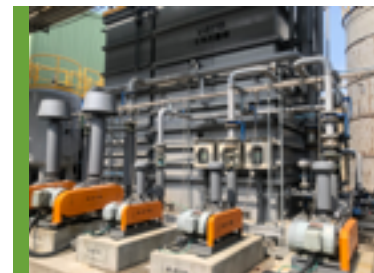
重合離心機廢水回收系統 (HBF)
