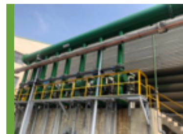
冷卻水主管路
