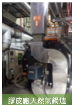
膠布廠天然氣鍋爐
