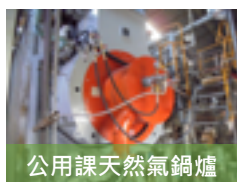
膠皮廠天然氣鍋爐
