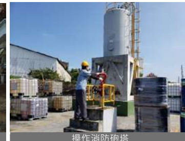
操作消防砲塔
