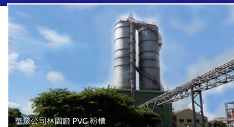
華聚公司林園廠 PVC 粉槽
