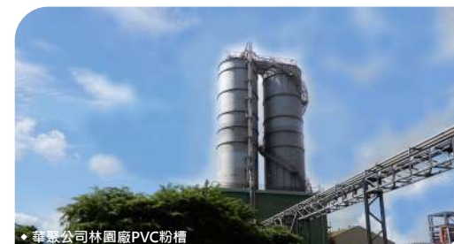
◆ 華聚公司林園廠 PVC 粉槽
