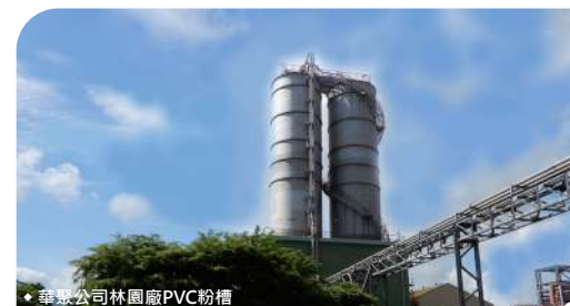
◆ 華聚公司林園廠PVC粉槽
